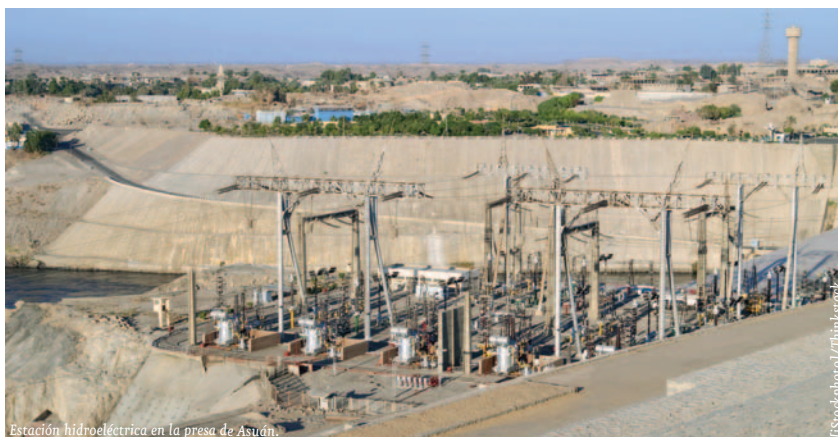
Estación hidroeléctrica en la presa de Asuán.
